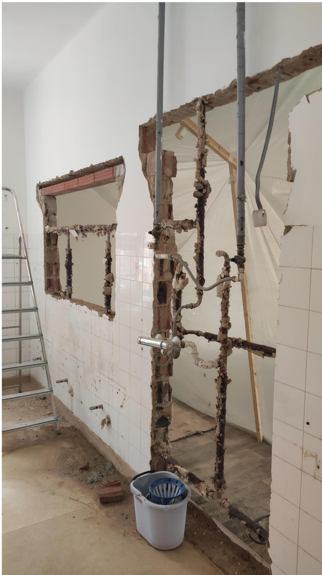
Vizesblokk felújítás előtt
